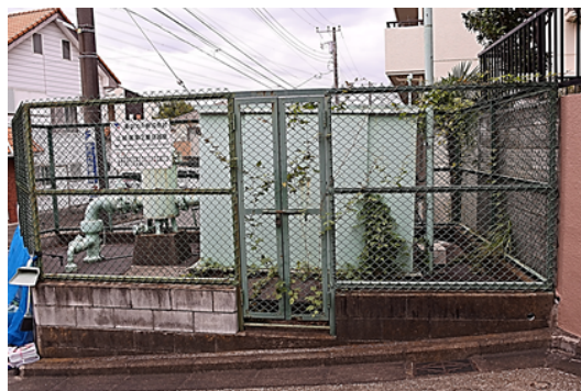
東京ガスの変圧器（上柏尾町:かなり大きい）
